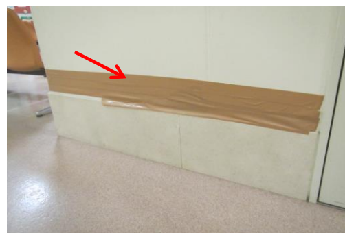
(2階患者待合室の柱根破損)
