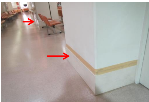
(2階患者待合室の柱根破損)
