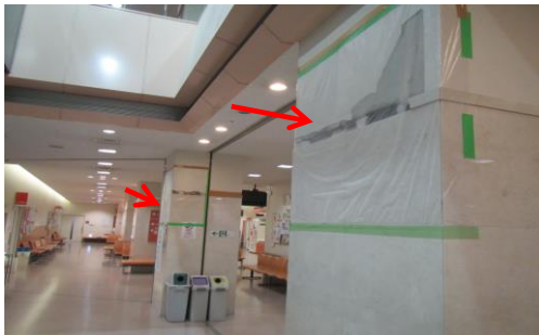
(1階患者待合室の柱破損)
