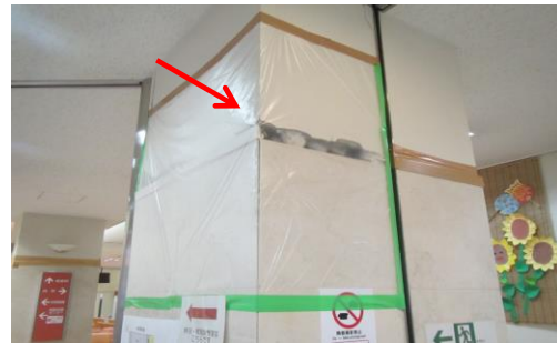
(1階患者待合室の柱破損)
